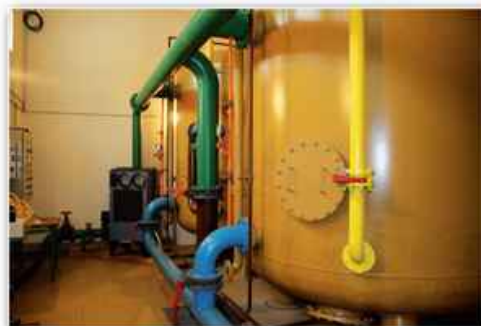
Unité de traitement de Devant Chaumont
